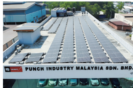
▲ マレーシア工場／太陽光パネル
