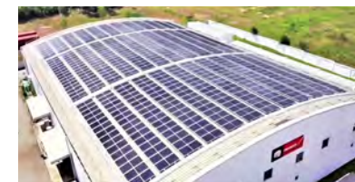
太陽光発電パネル (ベトナム工場)
